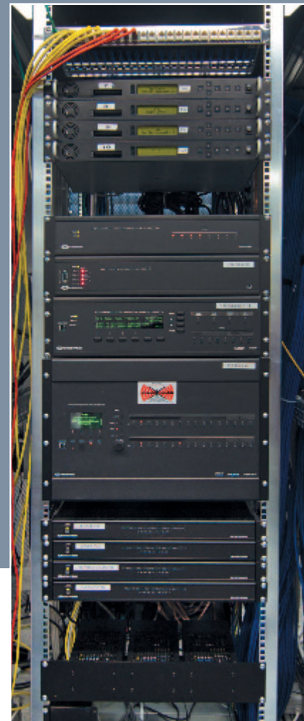
Blick in den Technikraum
