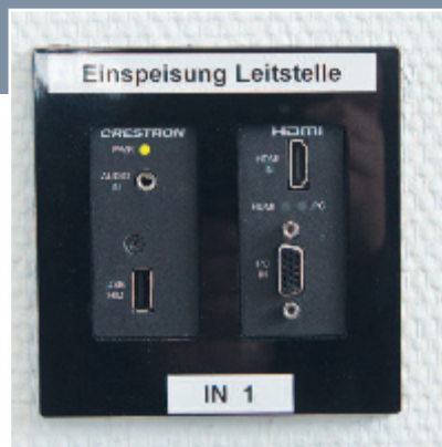
Einspeisepunkt für externe Quellen
